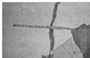
图 7 墙裂缝宽度实测图
