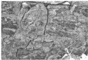
图15 基础出现裂缝图
